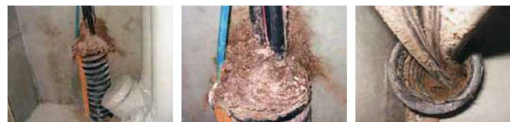
パイプシャフト内(共同住宅)の電気ケーブル(動力)パイプで見つかった蟻土。 ※埋設部より進入したと思われる。
