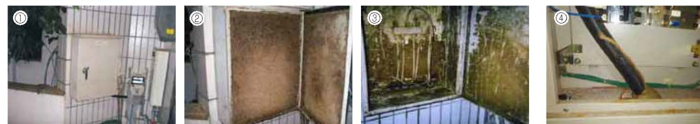
①TV用分電盤 ②蟻土が詰まっているTV用分電盤 ③蟻土撤去後のTV用分電盤 ④分電盤内の蟻道
