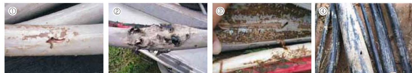
①シロアリの食害痕(損傷痕) ②シロアリ食害による漏電焼痕 ③ケーブル内にシロアリが生息している様子 ④シロアリの食害痕(損傷痕)
