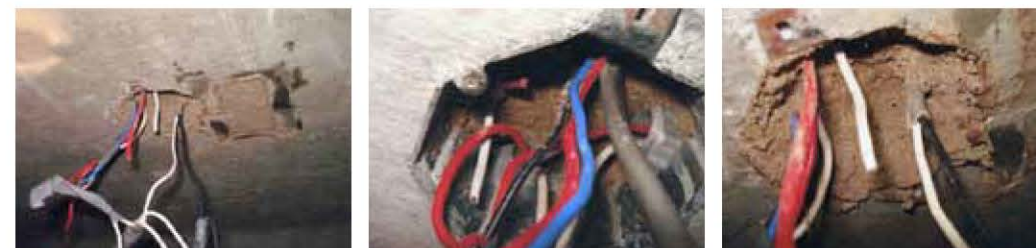
スラブコンクリート内の埋め込み配線ボックス内(照明器具)で見つかった蟻土 ※外部外灯等の埋め込み配管より進入したと思われる。
